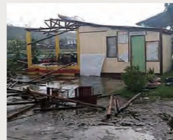
台風によって損壊した学校
